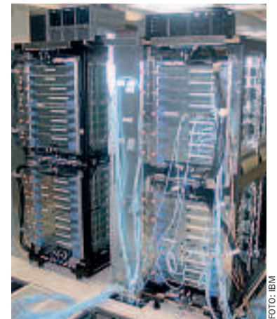
Zwei Blue-Gene-Racks beim Einbau in ein Rechenzentrum.
